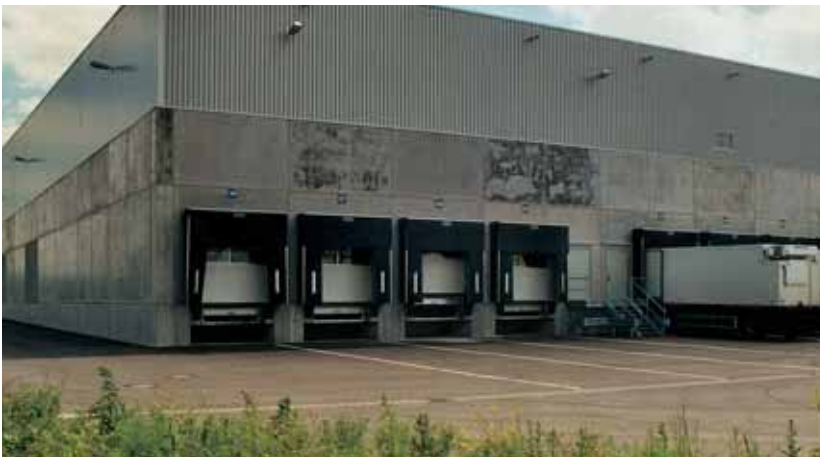
Etat général du béton avant lasurage.
