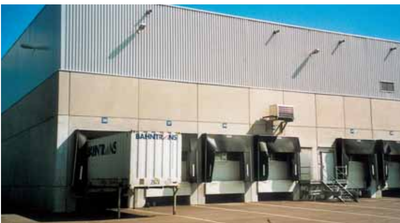
Aspect général homogène, après l'application de la lasure minérale KEIM Concretal®, les taches indésirables ont disparu.
