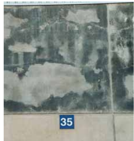
Taches très marquées au niveau du quai 35.
